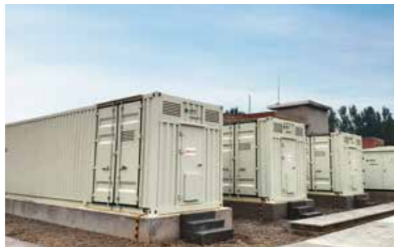
电网侧分布式电池储能电站
